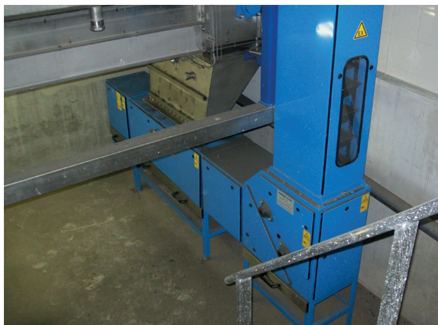
Élévateur à godets en sortie de sècheur.
