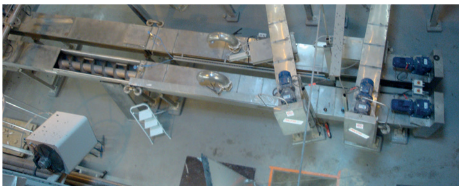
Deux vis de refroidissement des boues séchées en sortie de sècheur.
