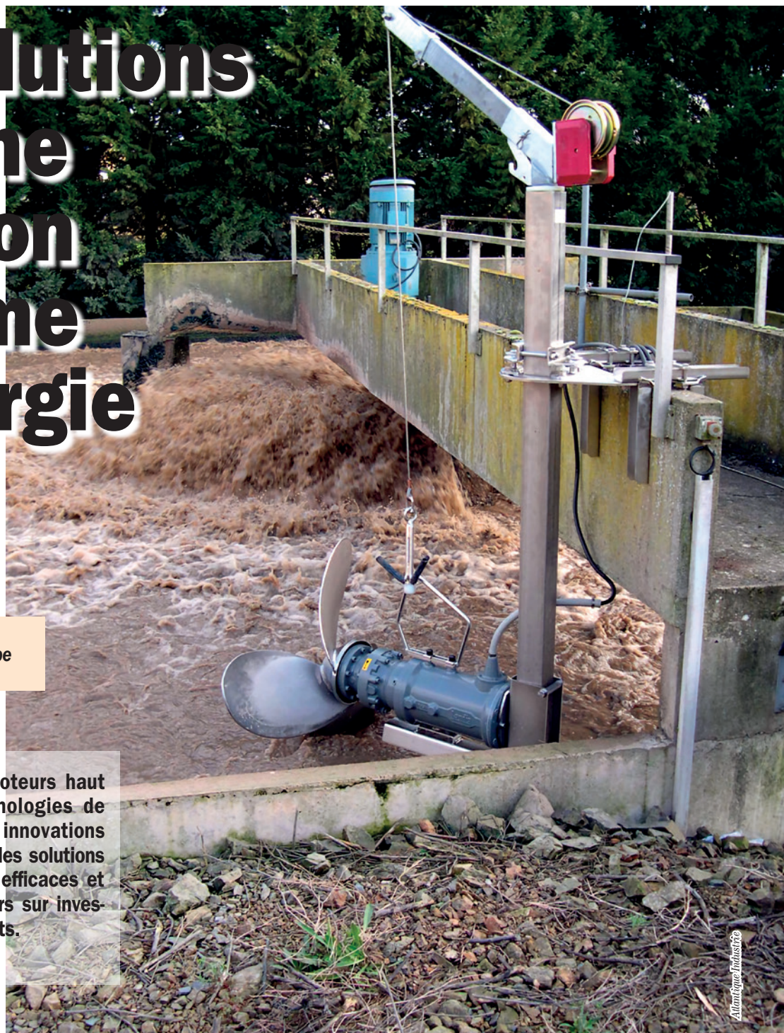
Agitateur Landia lent (150tr/mn) pour bassin d'aération.
