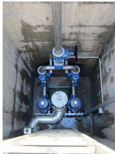
La SRL, station de relevage en ligne, supprime le stockage des eaux polluées, le dégrillage et le curage. Elle est équipée, en fosse sèche, de 2 pompes pompes monobloc verticales à volute, fonctionnant en variation de fréquence, optimisées pour les eaux usées. La section de passage intégral ainsi que les roues profilées évitent le bouchage.
