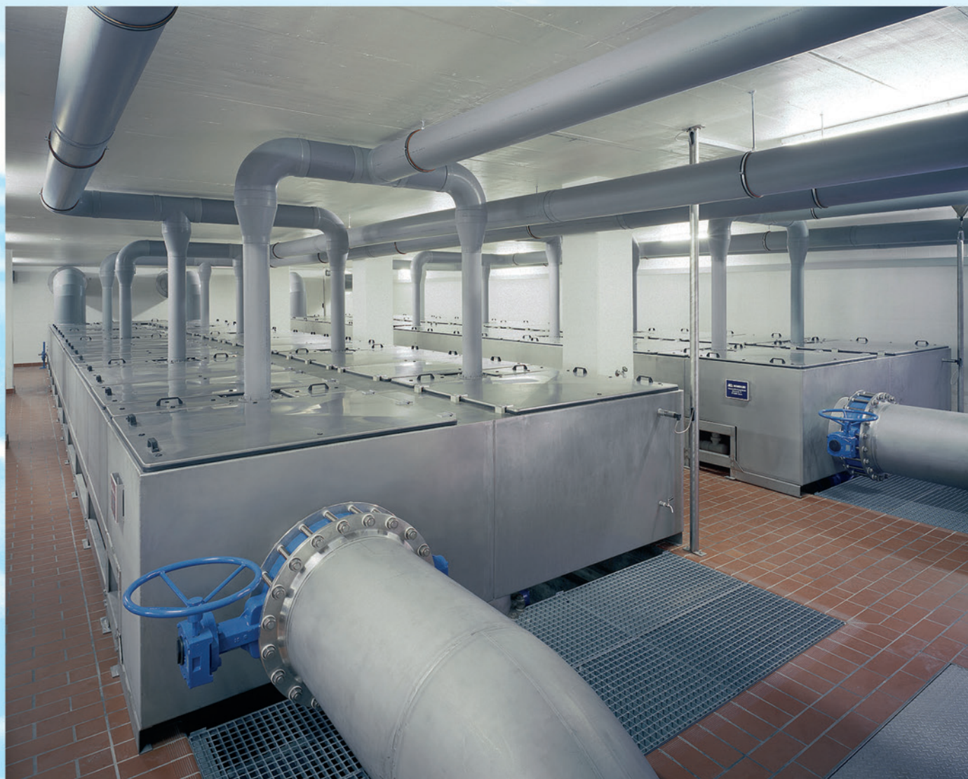
Installation des eaux potables de Bale – débit 1 400 m 3 /h
