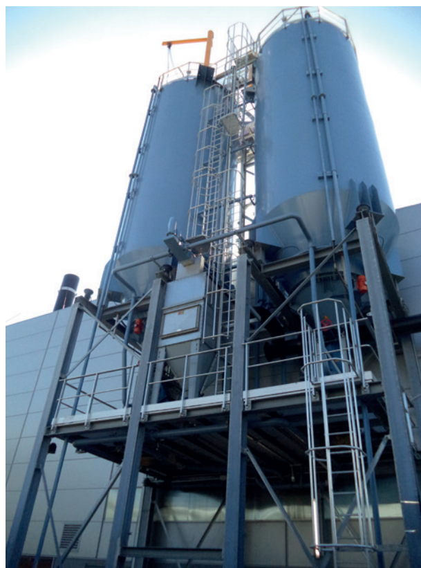
Silos de stockage des boues séchées.
